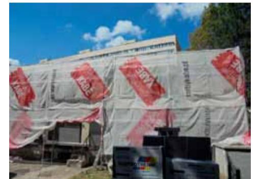
Trwa remont budynku przy ul. Drukarskiej 32 (Pizzeria). Obecnie prowadzone są roboty dociepleniowe od strony elewacji wschodniej.
